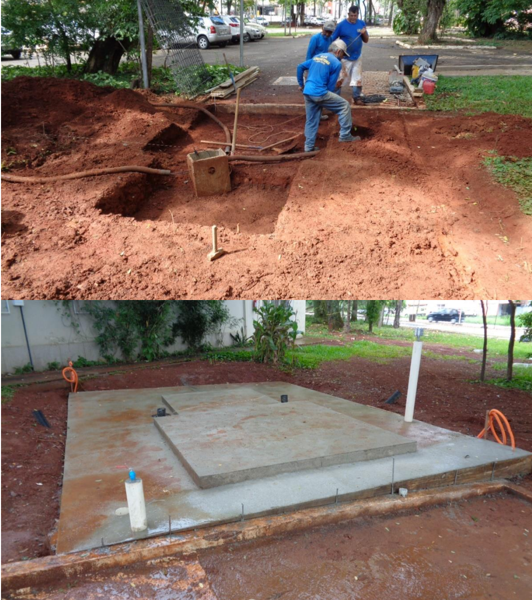
Figura 27. Detalhes da construção da base para futura instalação do tanque de nitrogênio líquido da White Martins
