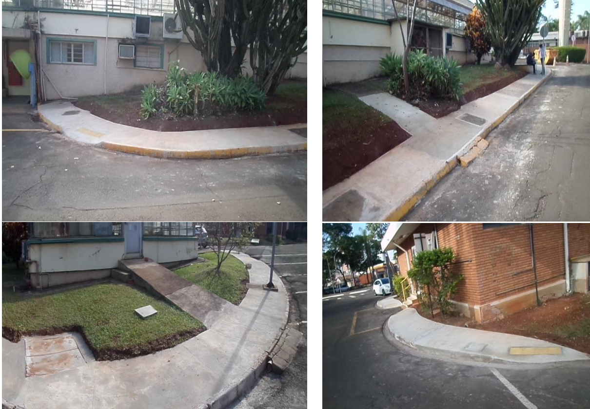
Figura 25. Detalhes de construção de calçadas nas dependências do CENA (plano diretor de espaço físico do CENA/USP)
