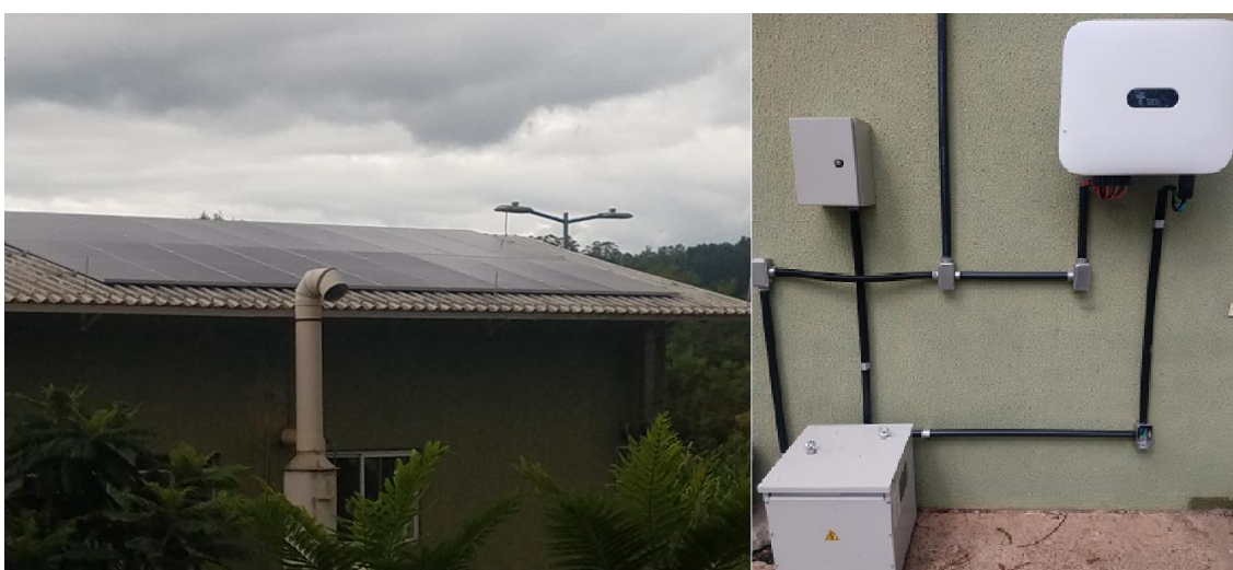
Figura 36. Detalhes do Kit Gerador de Energia Solar Fotovoltaica instalado no CENA, composto de placas fotovoltaicas, autotransformador e inversor Weq.
